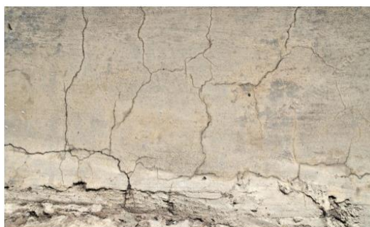
Figura 20 - Retração plástica do concreto.
