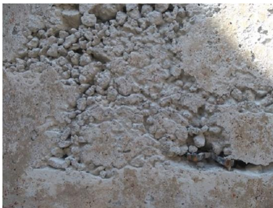
Figura 19 - Segregação do concreto.
