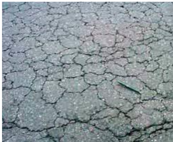
Figura 8 – Trinca couro de jacaré
