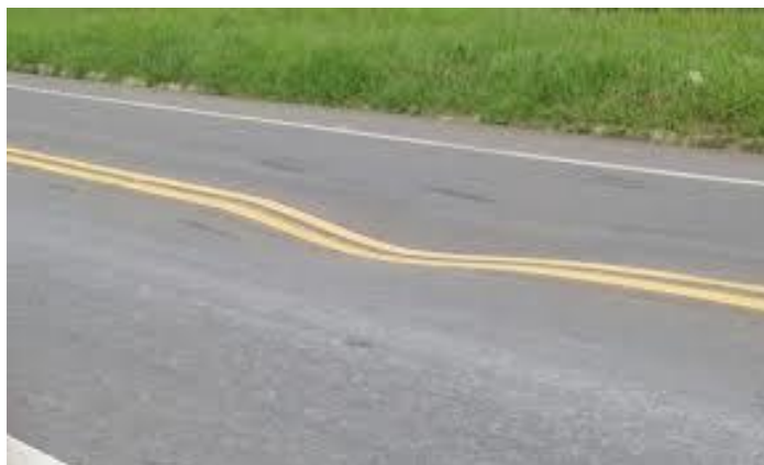
Figura 3 – Afundamento do asfalto
