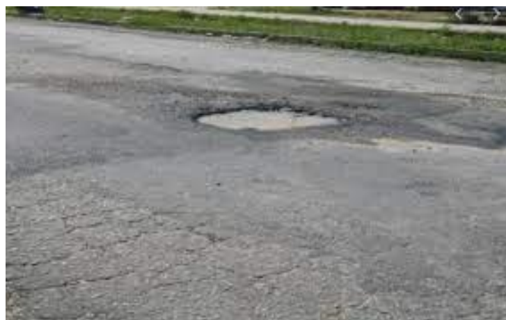
Figura 2 – Panelas no asfalto
