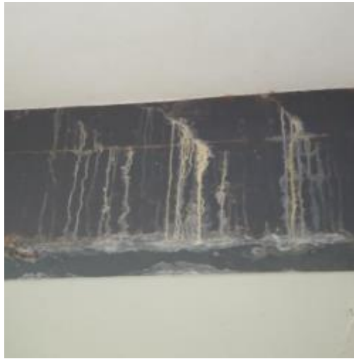
Figura 10 – Eflorescência presente em uma viga.
