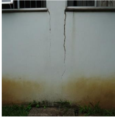
Figura 8 – Infiltração ascendente causada pela umidade excessiva do solo.
