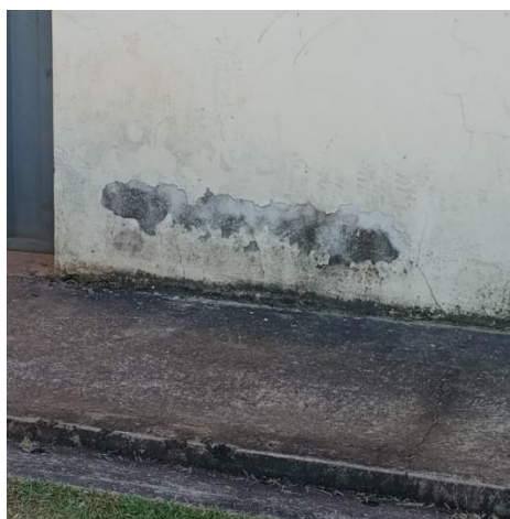
Figura 29 – Infiltração no piso e alvenaria do Departamento de Administração e Economia.
