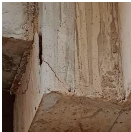
Figura 24 – Viga em processo de desagregação do concreto.
