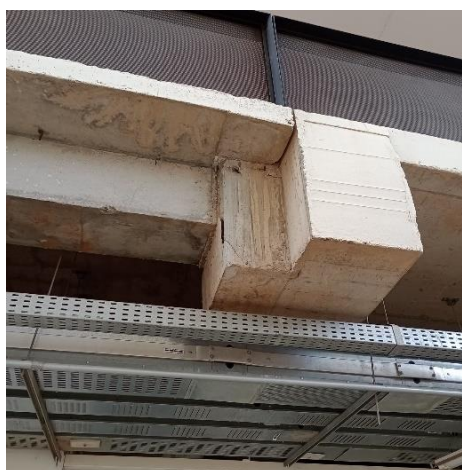
Figura 23 – Viga em processo de desagregação do cobrimento.
