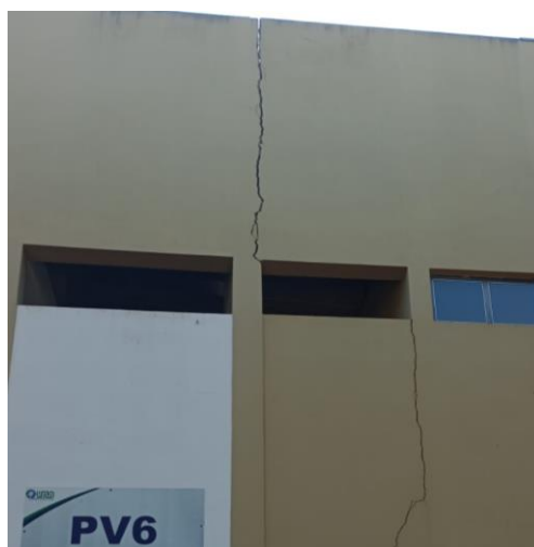
Figura 31 – Fendas presentes na alvenaria do Pavilhão 6.
