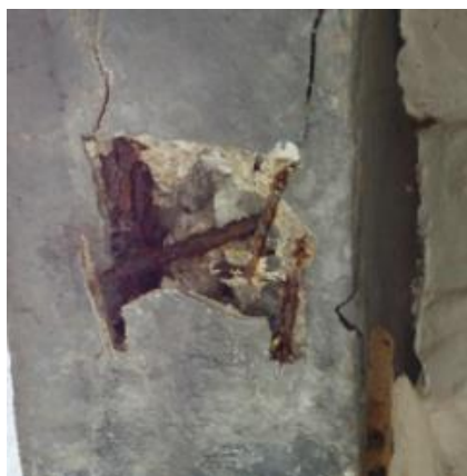
Figura 9– Corrosão das armaduras de uma viga.
