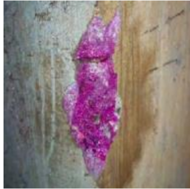
Figura 14 –Superfície de concreto após sofrer o processo de carbonatação.
