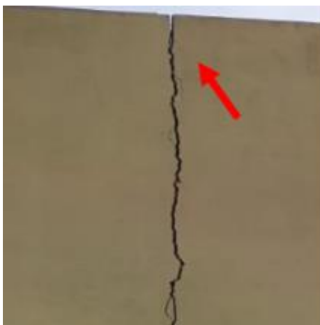
Figura 32 – Fendas presentes na alvenaria do Pavilhão 6.
