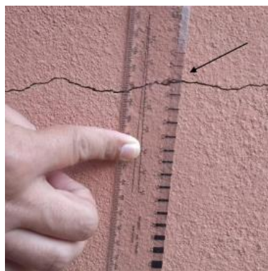
Figura 15 – Medição com fissurometro, fissura de 0,5mm.
