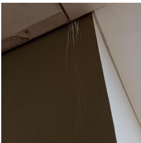
Figura 27 – Presença de mancha esbranquiçada em um componente da edificação.
