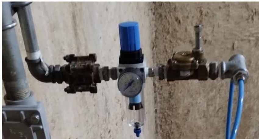
Figura 7 - Válvula reguladora de pressão e válvula solenoide para acionamento dos aspersores
