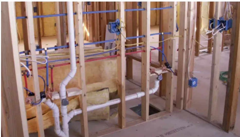
Figura 3.6 - Disposição das tubulações hidráulicas e conduítes na estrutura LWF.
