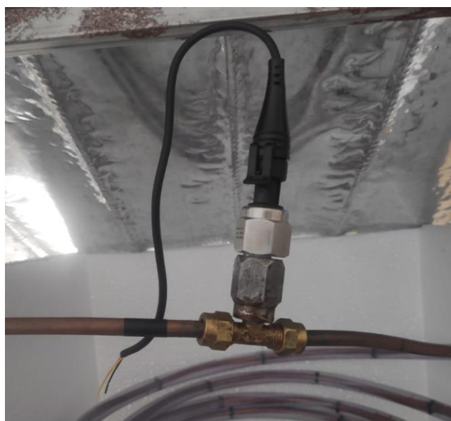
Figura 19 - Transdutor de pressão do condensador
