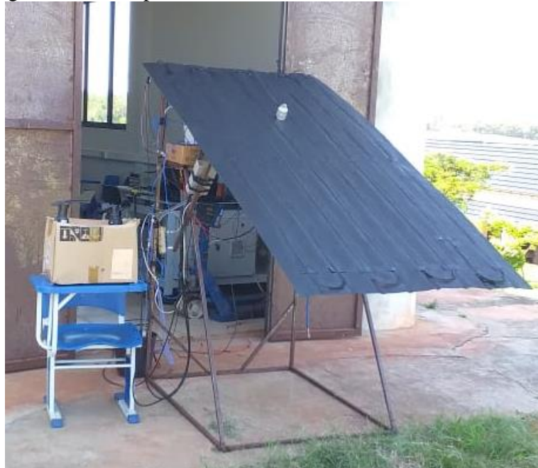
Figura 3.1 – Protótipo de bomba de calor DX-SAHP em funcionamento
