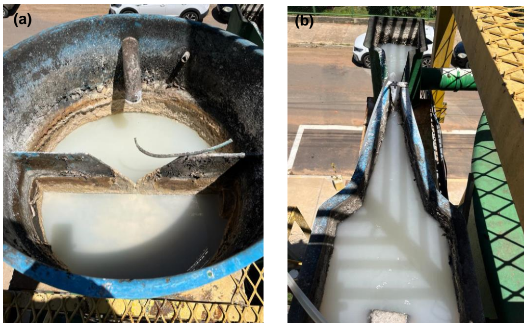
Figura 3 – (a) Caixa equalizadora de vazão com vertedouro triangular e (b) Calha Parshall da ETE em estudo.
