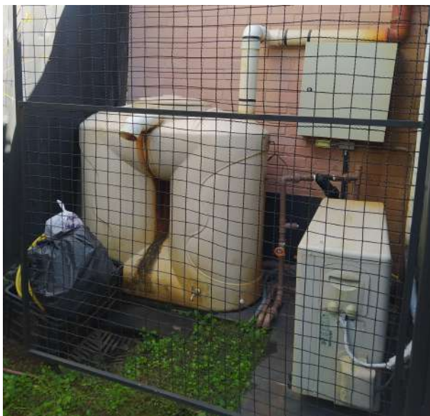
Figura 14 - Tanque de armazenamento de águas pluviais.
