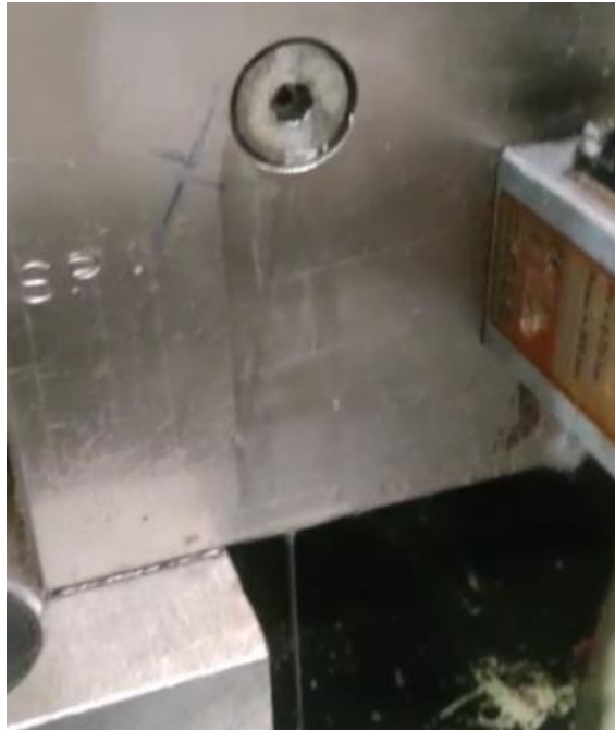
Figura 42 – Vazamento de óleo no bloco hidráulico da prensa
