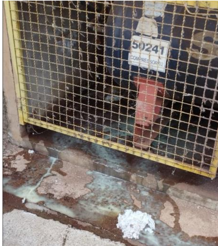
Figura 40 – Água com óleo após drenagem do compressor
