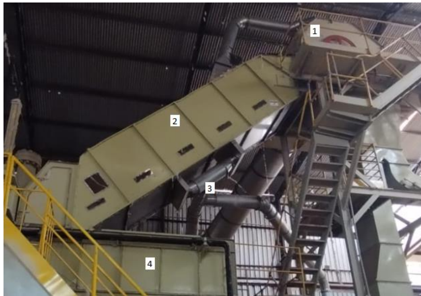
Figura 33 - 1(Condensador), 2(bica), 3(tubulação de chegada do ar do umidificador), 4(empurrador hidráulico)
