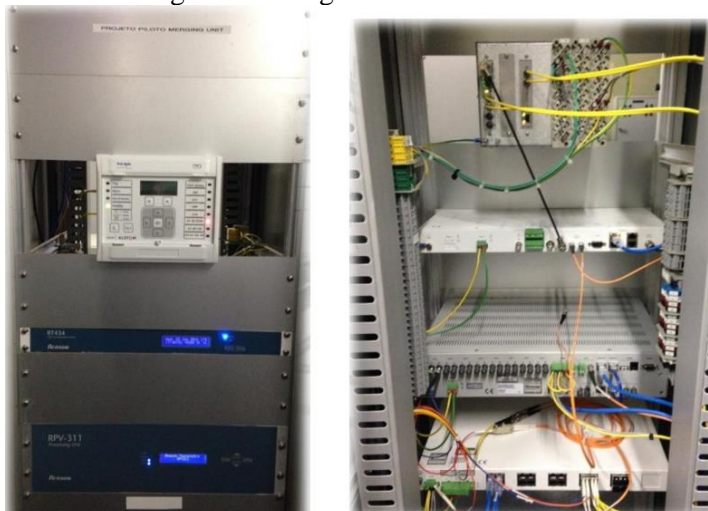
Figura 5.4 Imagem Casa de Controle
