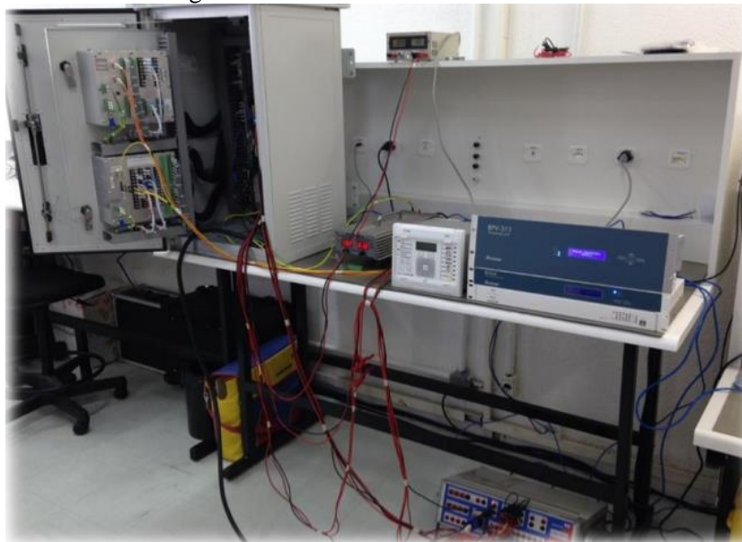
Figura 5.3 Sistema montado em Fabrica
