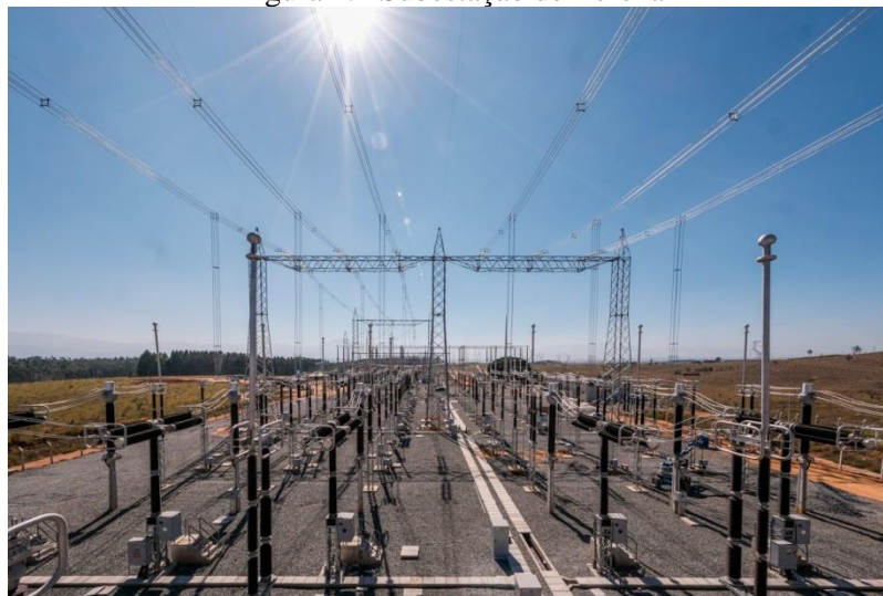
Figura 2.1 Subestação de Lorena
