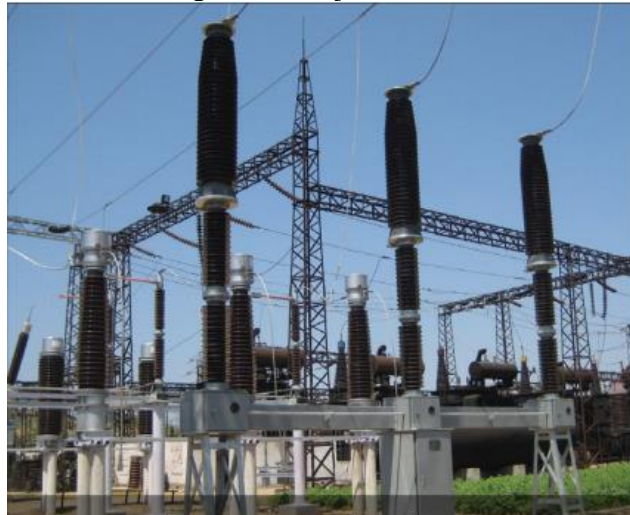
Figura 2.6 Disjuntor a SF6
