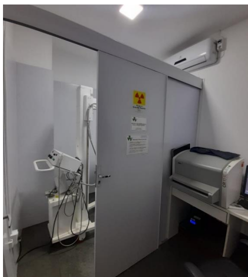
Figura 26 - Sala de Raio X do Hospital Veterinário Vet&Pet.
