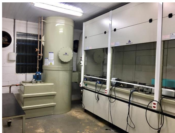
Figura 9 - Sala de digestão do 3RLAB.
