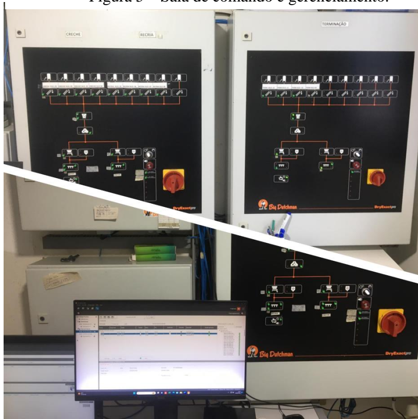
Figura 5 – Sala de comando e gerenciamento.
