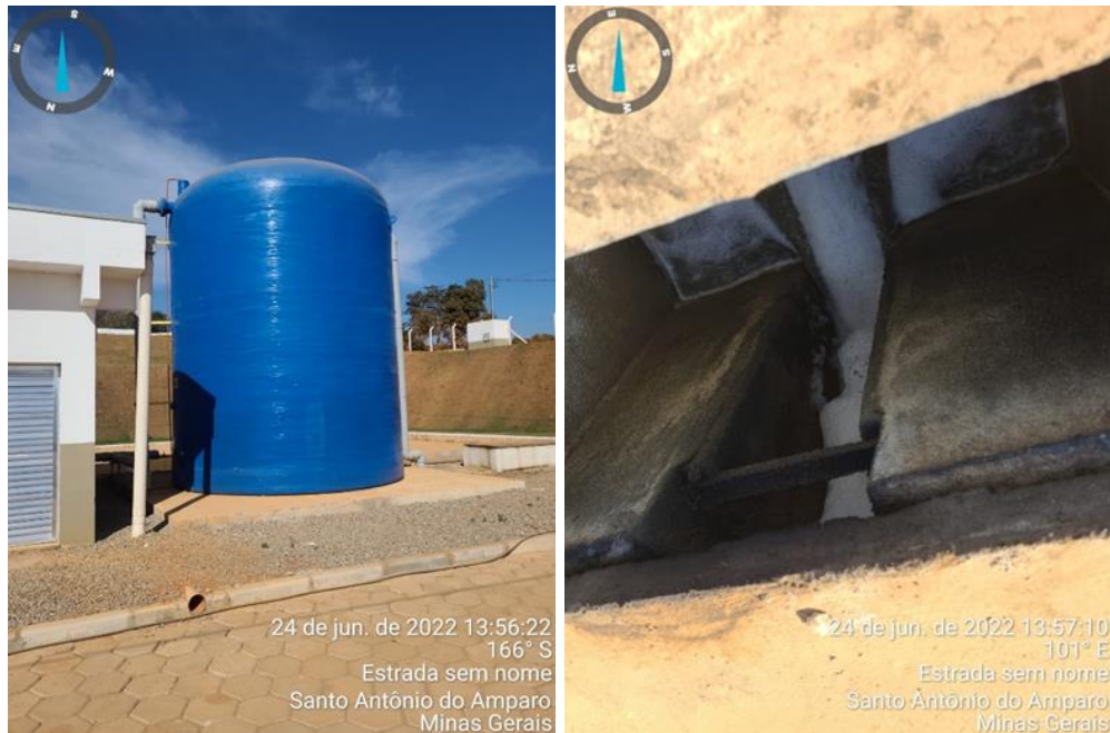
Figura 12: A direita tanque de cloração e a esquerda Calha Parshall.
