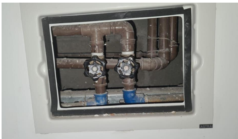
Figura 21 – Shaft hidráulico do residencial Olympia.
