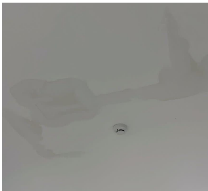
Figura 16 – Infiltração encontrada em apartamento do 4º andar.
