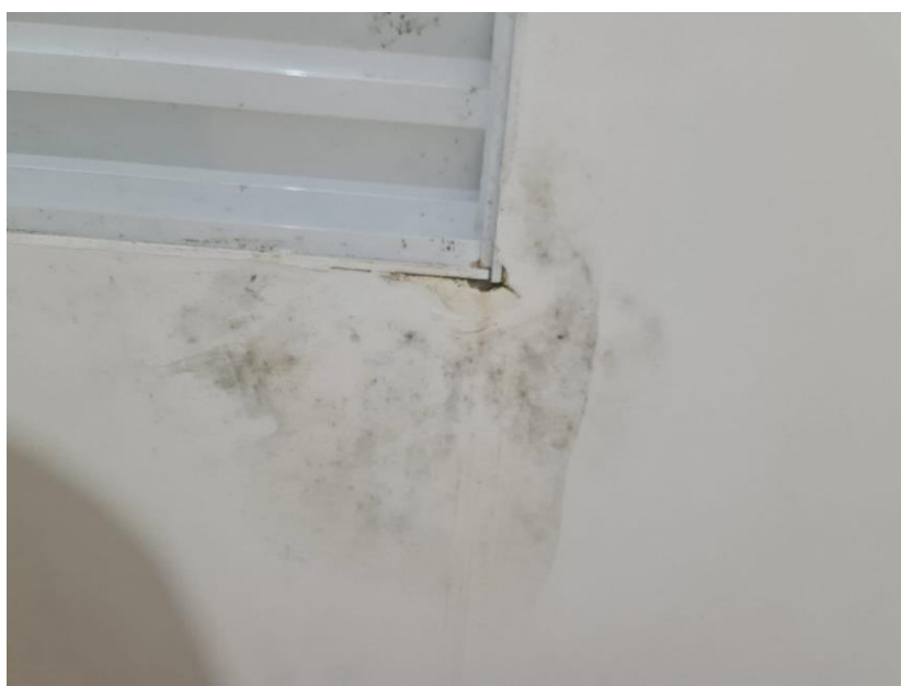
Figura 17 – Mofo decorrente de infiltração.
