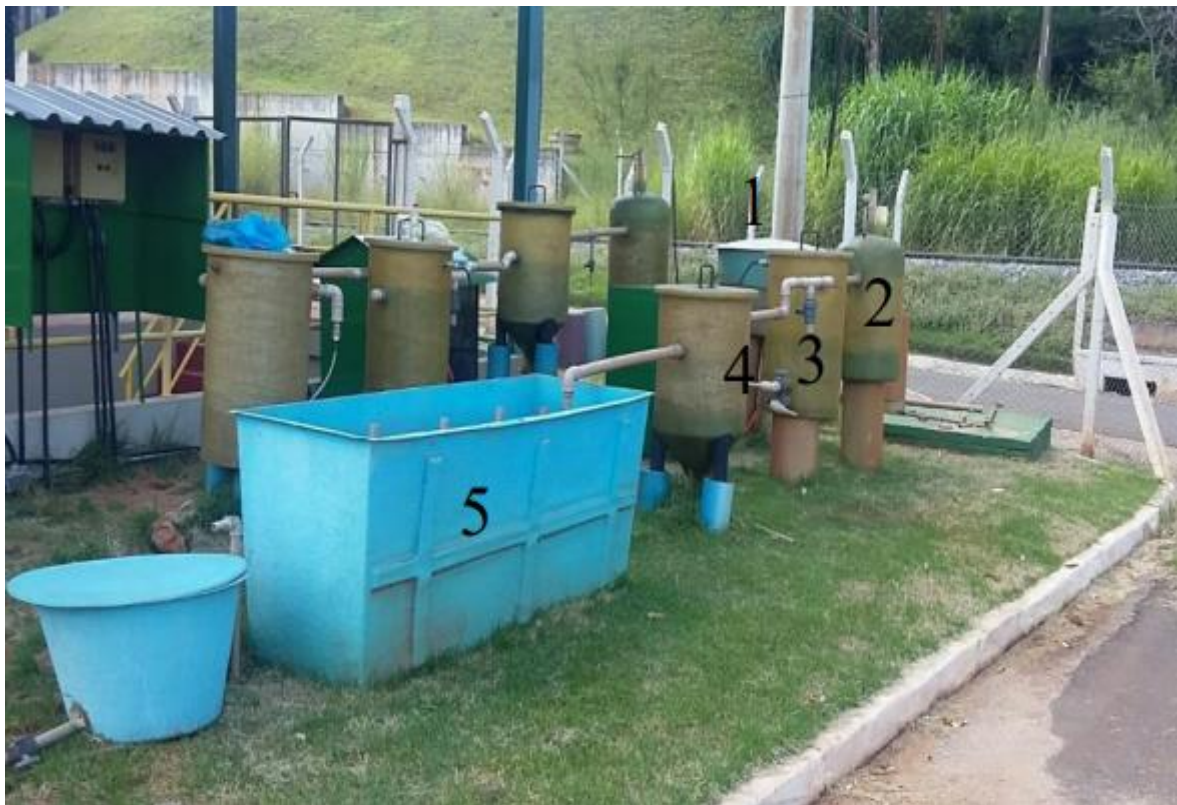
Figura 1: Sistema de tratamento de esgoto com reator TEq (1), RAFA (2), FBAS (3), DS (4) e SAC (5), localizado na ETE-UFLA, usados para o experimento do tratamento do esgoto sanitário da UFLA.
