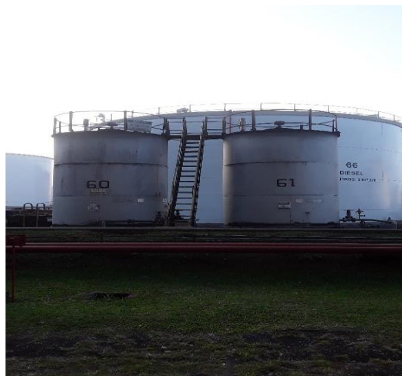
Figura 11 - Tanques para armazenagem de resíduos líquidos contaminados
