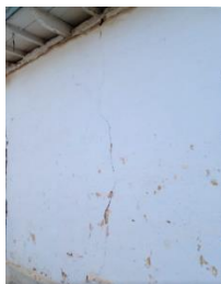
Figura 43 – Trinca na fachada
