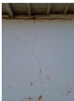
Figura 51 – Fissura na fachada
