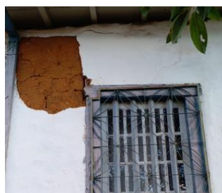
Figura 48 – Desprendimento do reboco
