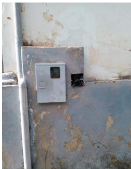
Figura 39 – Quadro de energia
