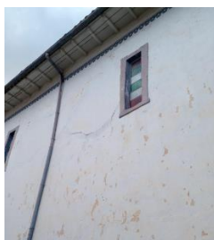
Figura 44 – Desprendimento de reboco
