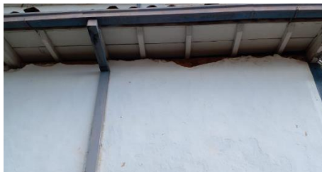
Figura 49 – Desprendimento do reboco
