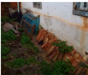
Figura 45 – Acúmulo de entulho
