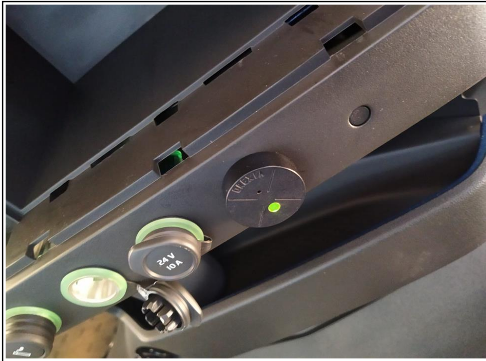
Figura 4.15 - Instalação do leitor RFID no painel do veículo.
