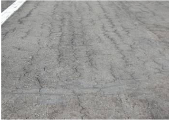
Figura 11 - Exemplo de dano por fadiga em pavimento asfáltico.
