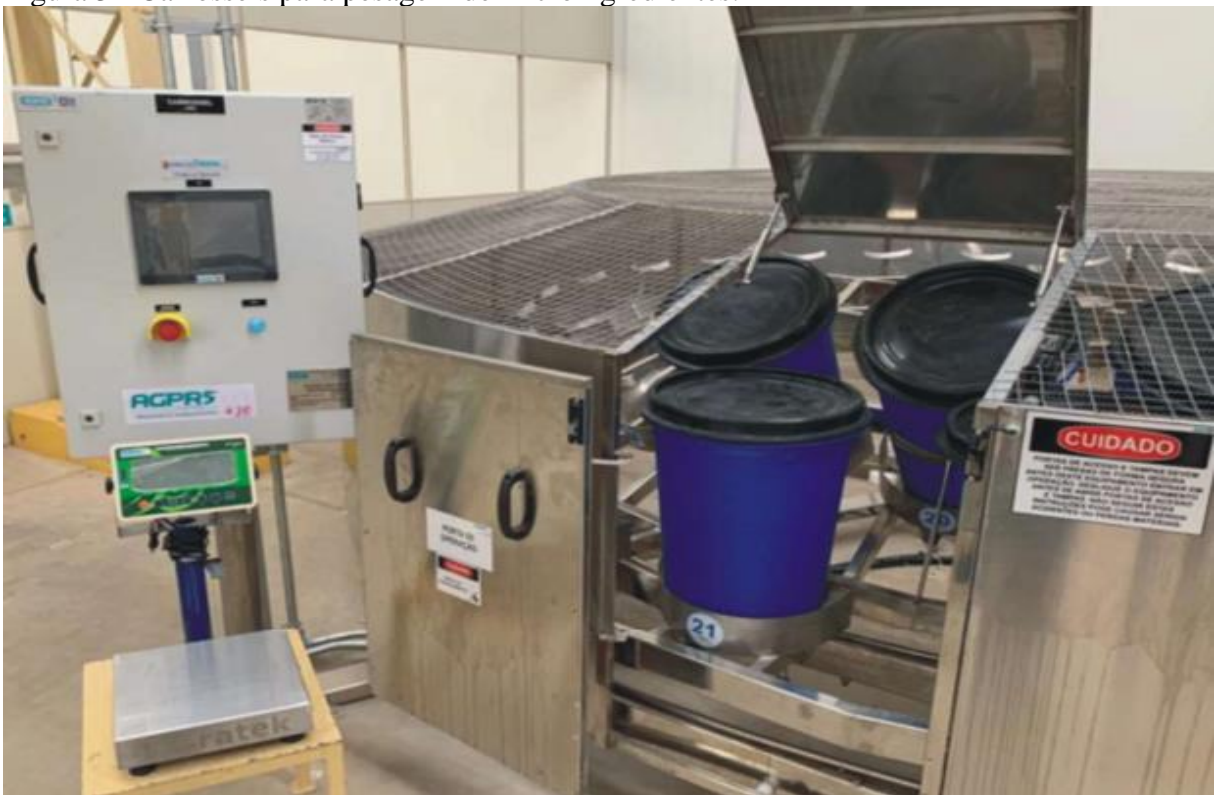
Figura 3 - Carrosséis para pesagem de microingredientes.
