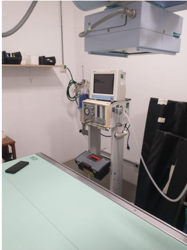
Figura 6: Vista parcial da sala de radiografia
