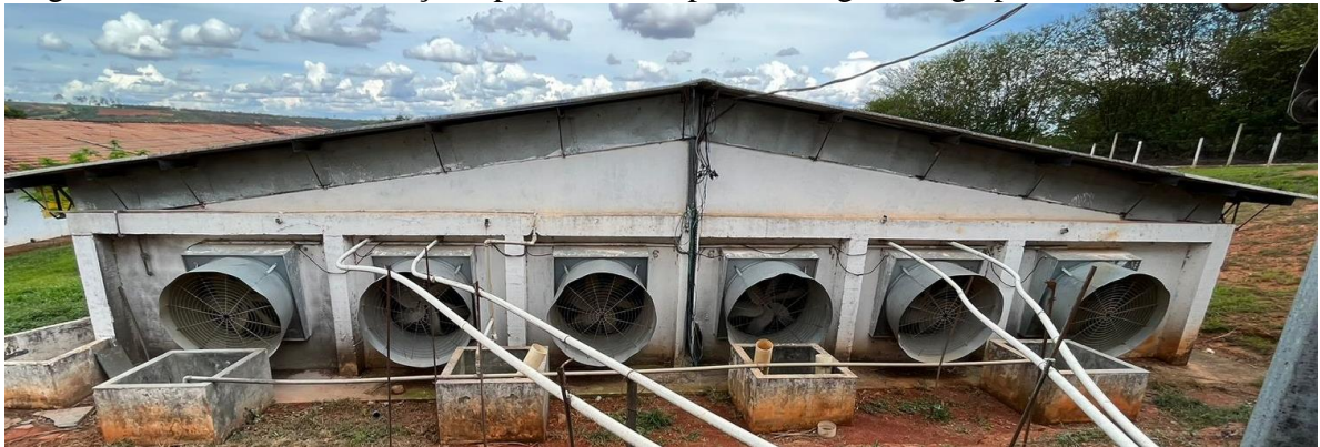
Figura 7. Sistema de ventilação tipo túnel com pressão negativa– galpão 4
