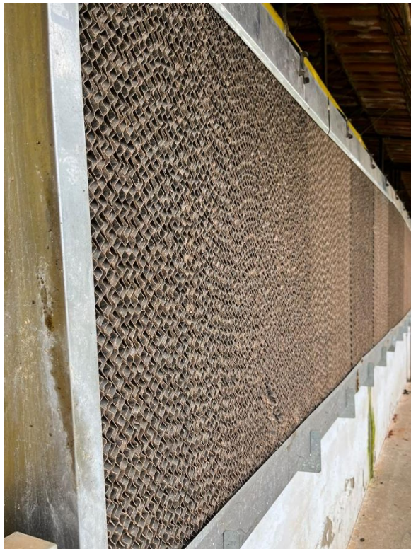
Figura 6. Sistema de resfriamento evaporativo de placas de celulose umedecidas – galpão 4.
