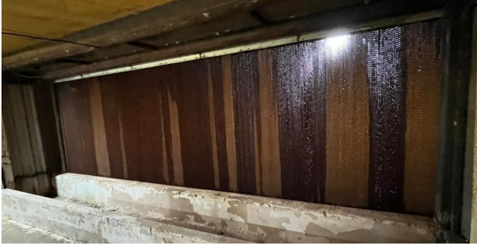
Figura 5. Sistema de resfriamento evaporativo de placas de celulose umedecidas – galpão 4
