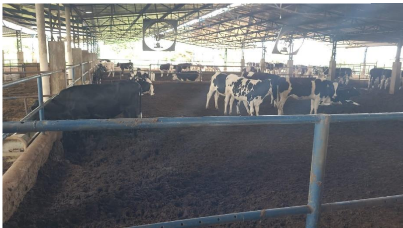
Figura 15. Verificação dos ventiladores do compost barn .
