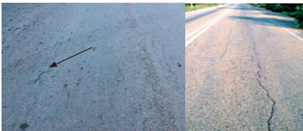
Figura 7 – Trincas Longitudinais Curtas e Longas
