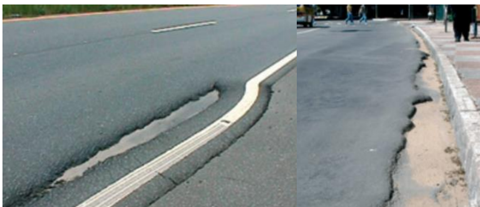
Figura 12 – Trechos com escorregamento de massa
