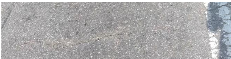
Figura 6 – Trinca Transversal Curta
