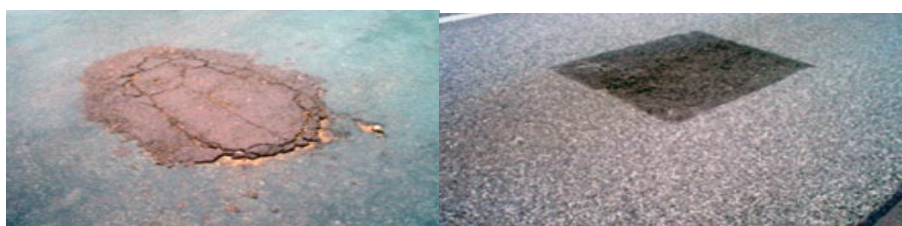
Figura 16 – Remendos com diferenças na execução.
