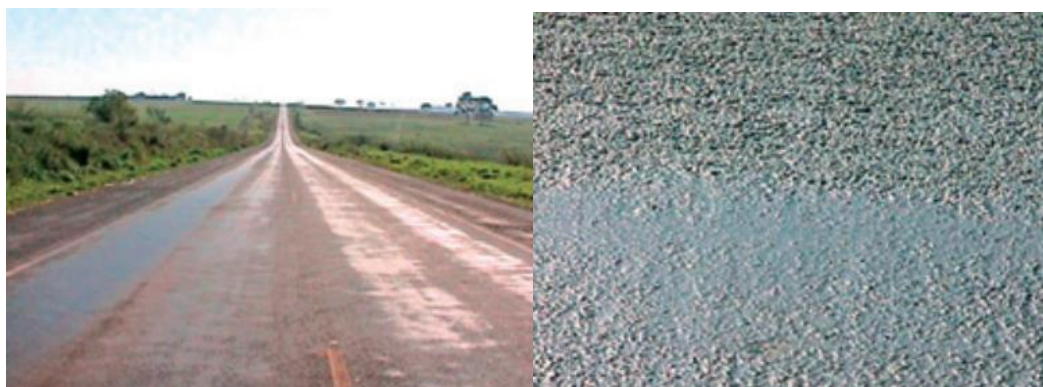
Figura 13 – Exsudação em trecho de pista e exsudação em detalhe
