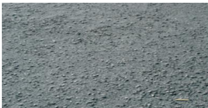
Figura 14 – Desgaste com desprendimento de agregados
