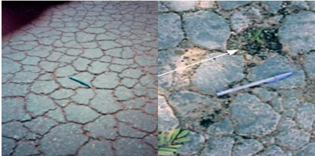
Figura 9 – Trecho com presença de “Couro de Jacaré” simples e com erosão
