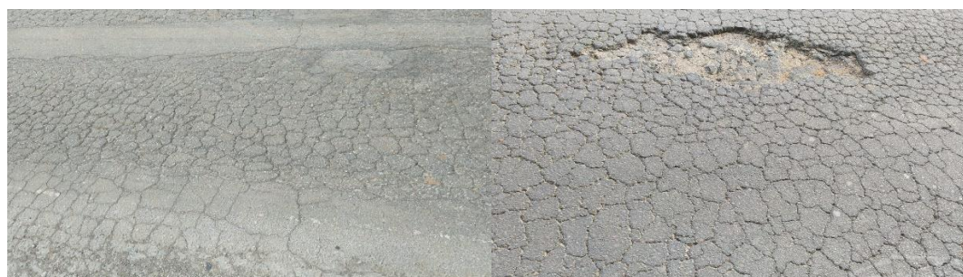
Figura 22- Patologias graves encontradas no Trecho3
