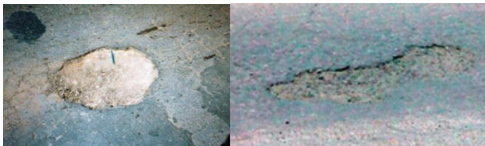
Figura 15 – Painelas em diferentes estágios de degradação
