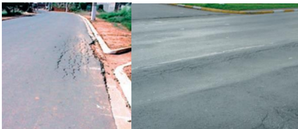
Figura 11 – Afundamento Localizado e em Trilha de Roda
