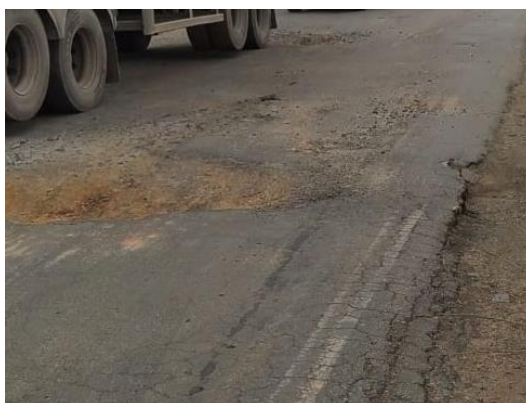
Figura 21 - Associação de patologias em estação do Trecho 1
