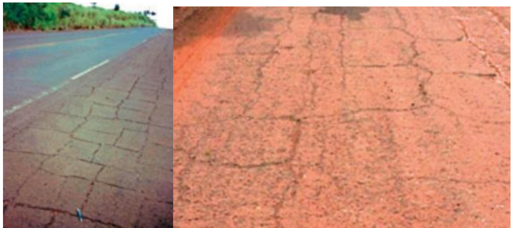
Figura 10 – Trecho com presença do tipo “Bloco” simples e com erosão
