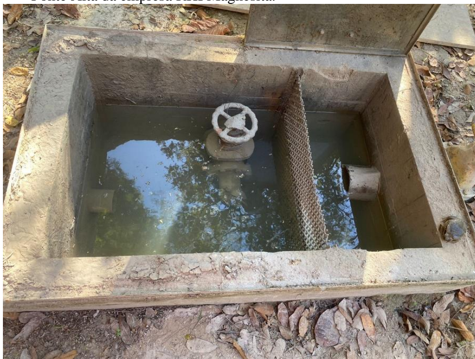
Figura 3 - Unidade de gradeamento do tratamento de efluentes industriais da Unidade Ponte Alta da empresa RHI Magnesita.
