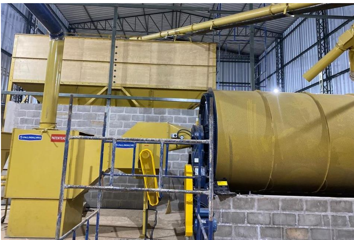
Figura 3 - Galpão de beneficiamento: secador rotativo
