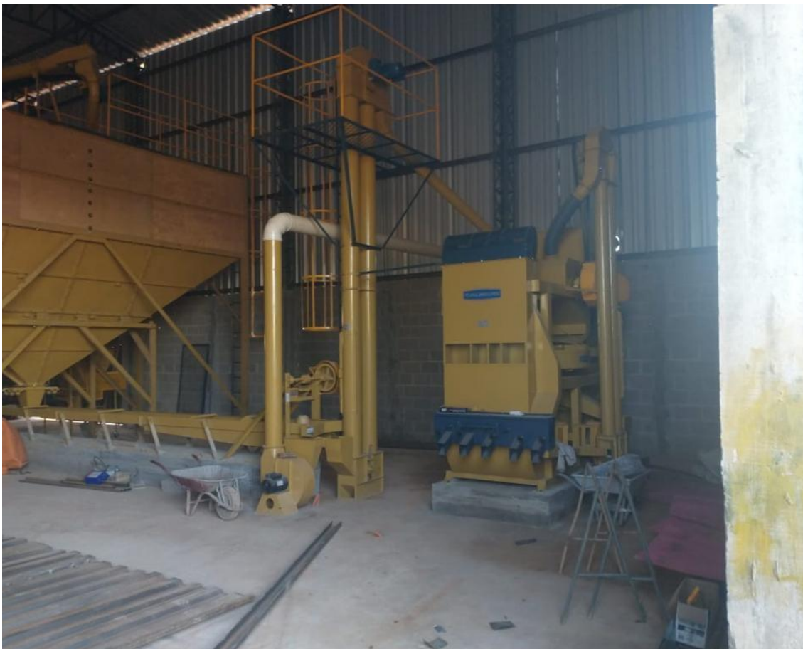
Figura 4 - Galpão de beneficiamento: separador de grãos
