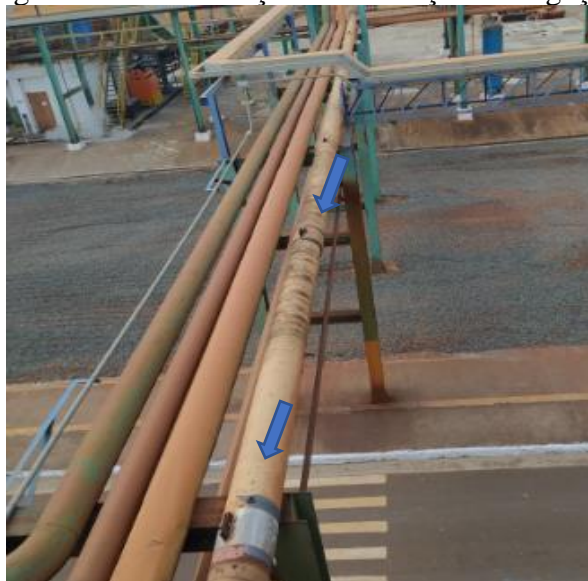
Figura 19 - Continuação da tubulação de bagaço.
