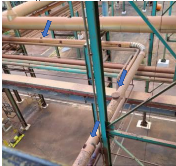
Figura 18 - Tubulação de bagaço.
