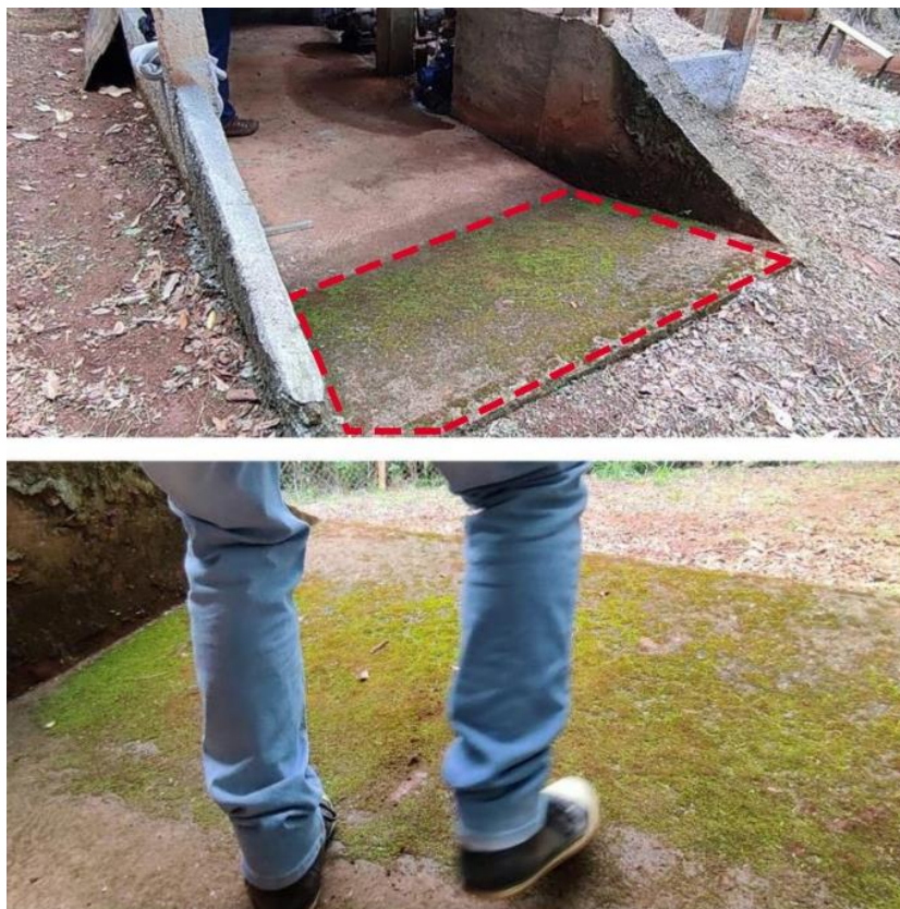
Figura 22 - Rampa com lodo.
