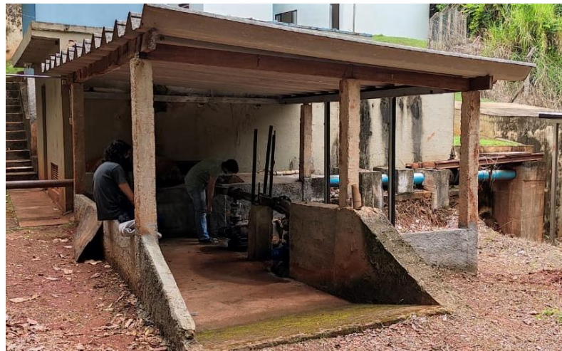
Figura 6 – Local das bombas na estação.
