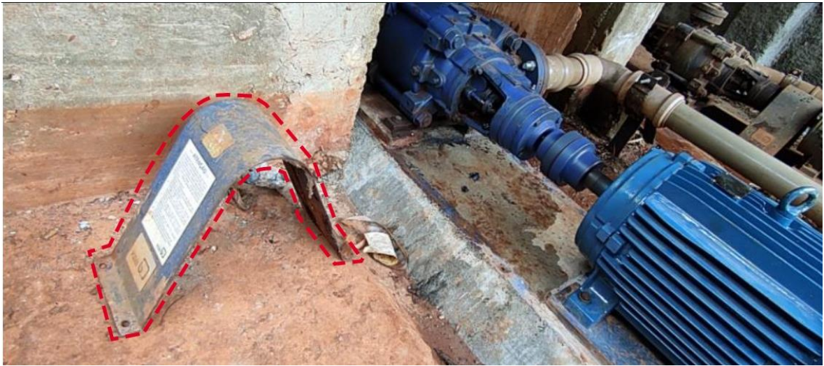
Figura 12 – Peças ao redor da bomba.
