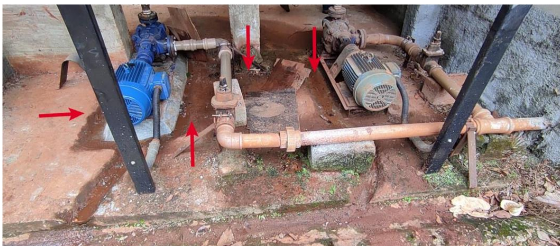
Figura 23 - Sistema apresentando acúmulo de água na base.
