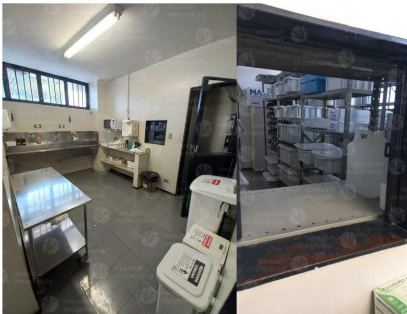
Figura 17 - Sala de paramentação com janela comunicando com a sala de armazenamento de instrumentais cirúrgicos.
