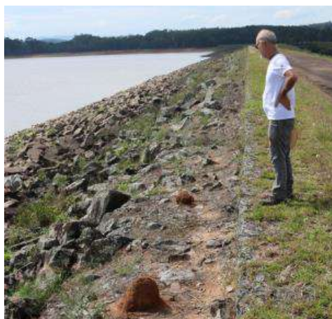
Figura 8 – Formigueiros no talude de montante.
