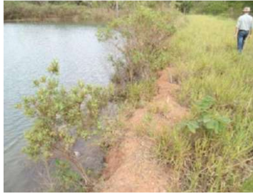
Figura 3 – Borda livre insuficiente.
