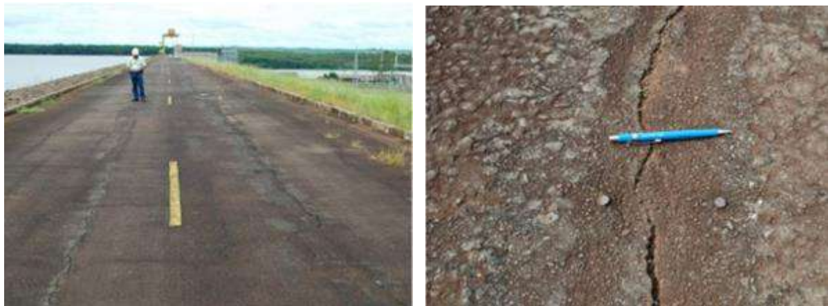
Figura 7 – Trinca no revestimento asfáltico na crista da barragem: (a) Fotografia com enquadramento mais abrangente e (b) Fotografia mais detalhada.
