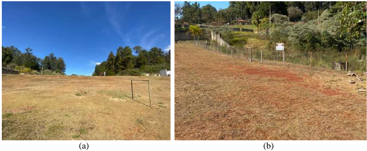
Figura 16 – Talude jusante e crista do barramento: (a) Talude de jusante e (b) Crista.
