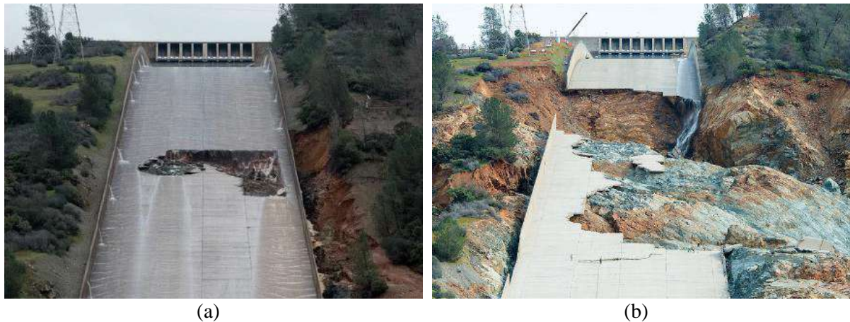
Figura 9 – Vertedouro danificado na barragem de Oroville: (a) antes e (b) após a ruptura da barragem.
