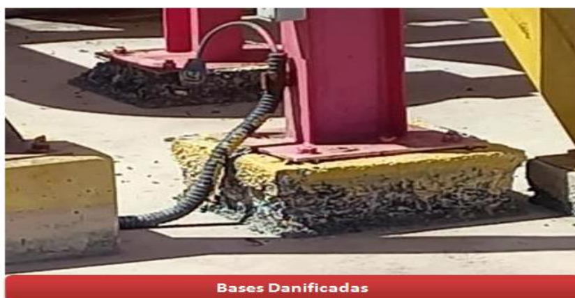
Figura 5 - Bases de apoio desgastadas.
