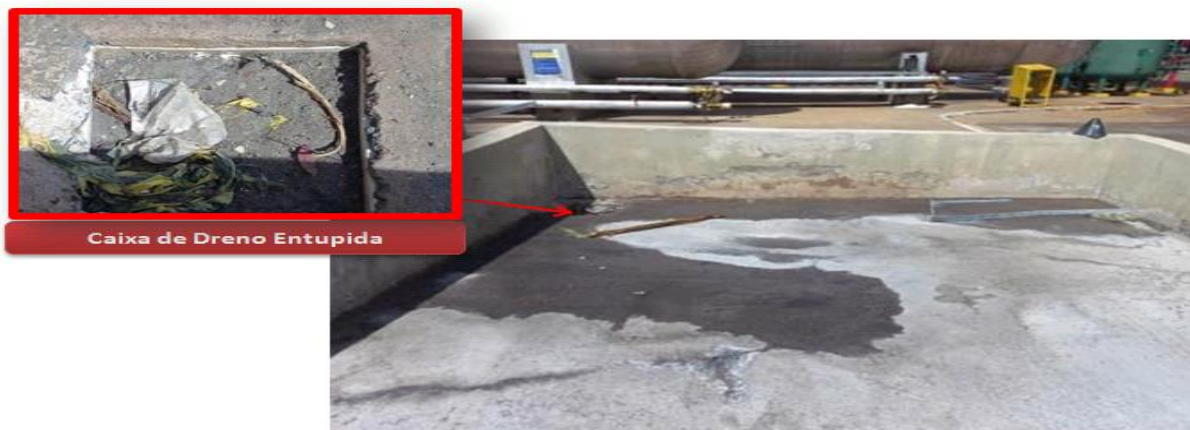
Figura 4 - Caixa de dreno, área de descarregamento.
