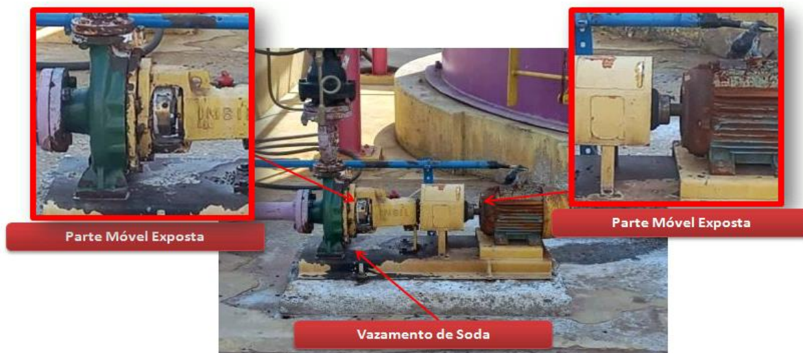
Figura 3 - Estado da bomba de envio antes.
