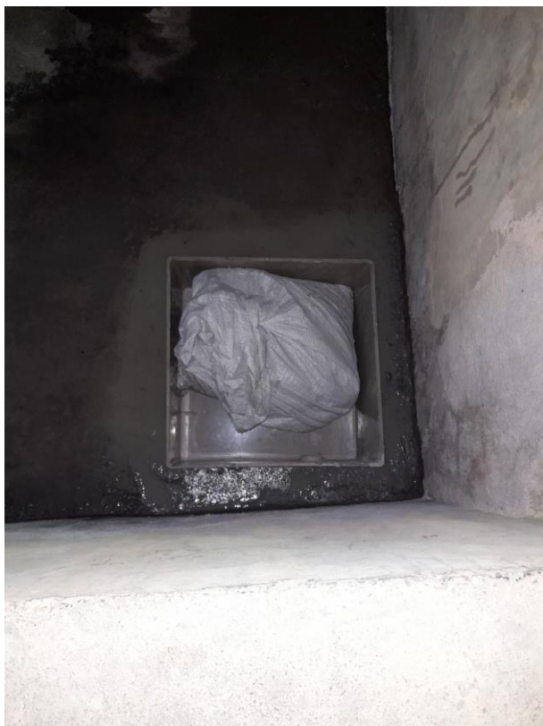
Figura 15 - Caixa de Drenagem desentupida.
