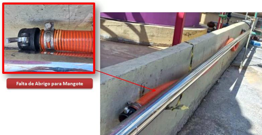
Figura 2 - Armazenamento da tubulação de descarte antes.
