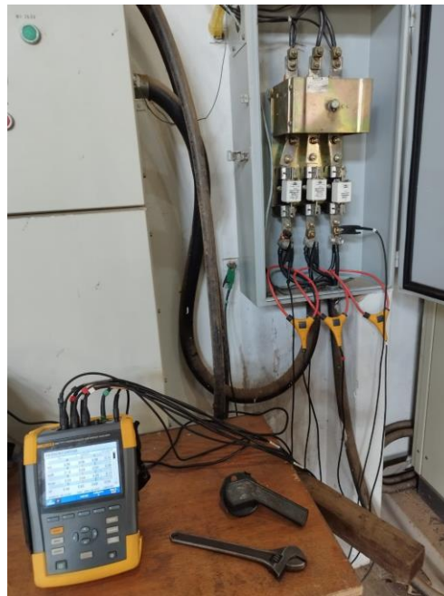
Fig. 6 – Analisador de qualidade de energia Fluke, modelo 435 – II conectado ao painel elétrico de alimentação.
