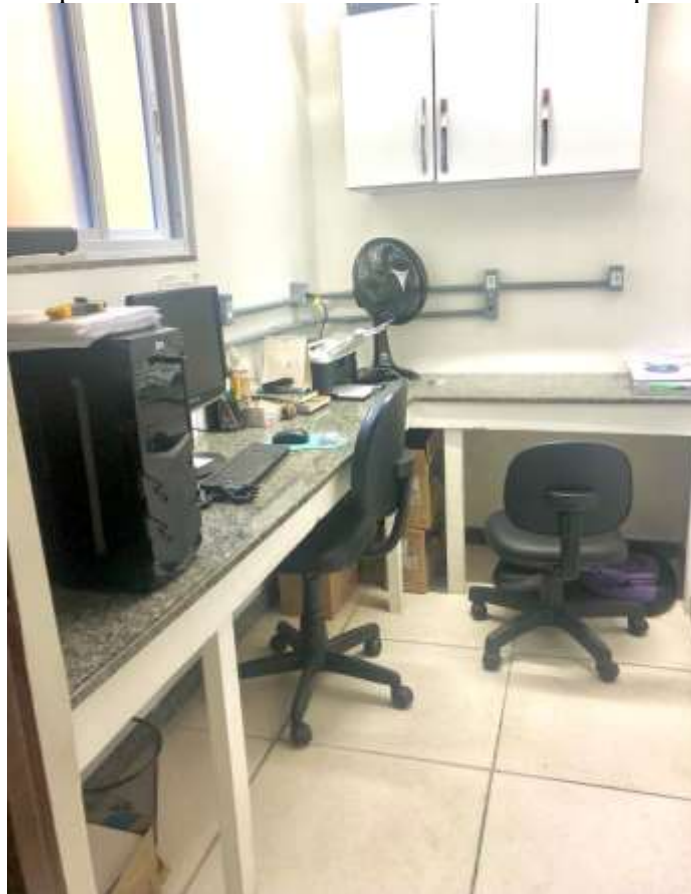
Figura 14 – Vista parcial da telefonia do Centro Veterinário Especializado VetLife
