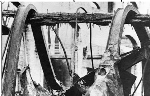
Figura 3 - Estrutura de aço e madeira após incêndio
