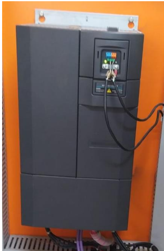
Figura 6 – Inversor de frequência da família MM440, sendo este especificamente utilizado para o acionamento dos motores sopradores da ETE-UFLA.
