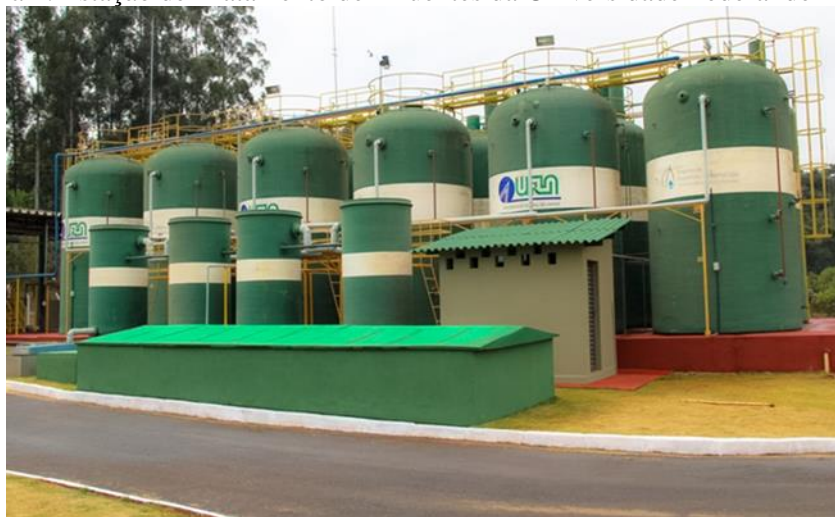
Figura 4. Estação de Tratamento de Efluentes da Universidade Federal de Lavras.
