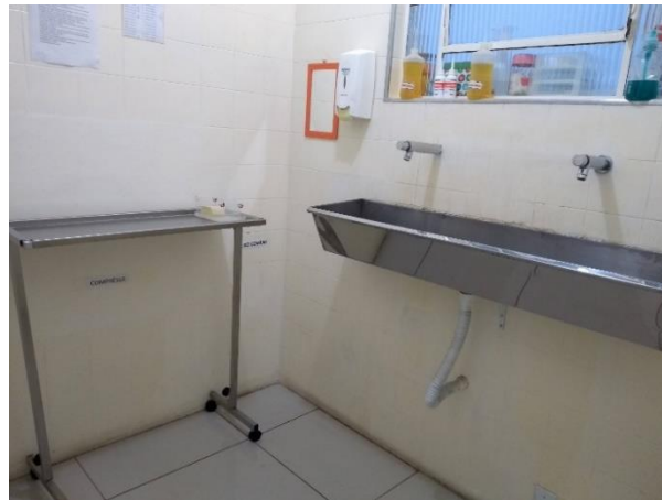
Figura 6 - Sala de paramentação da Vital Centro Clínico Veterinário.
