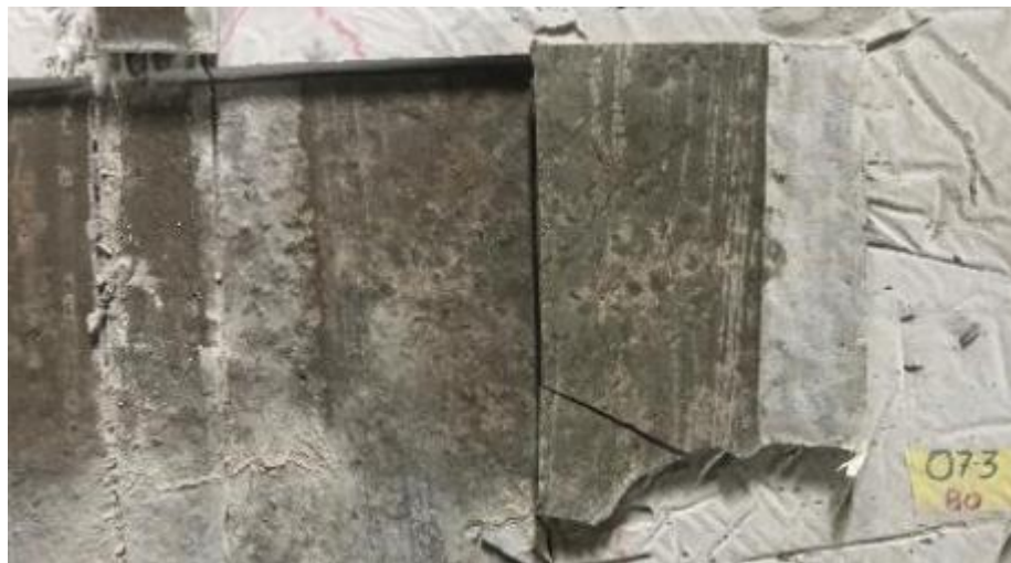
Figura 26 - Condição O7 – Ruptura na interface impermeabilizante X laje.
