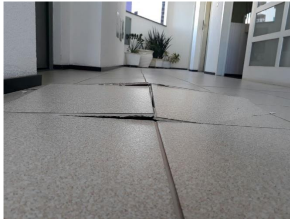
Figura 5 - Deslocamento cerâmico generalizado.
