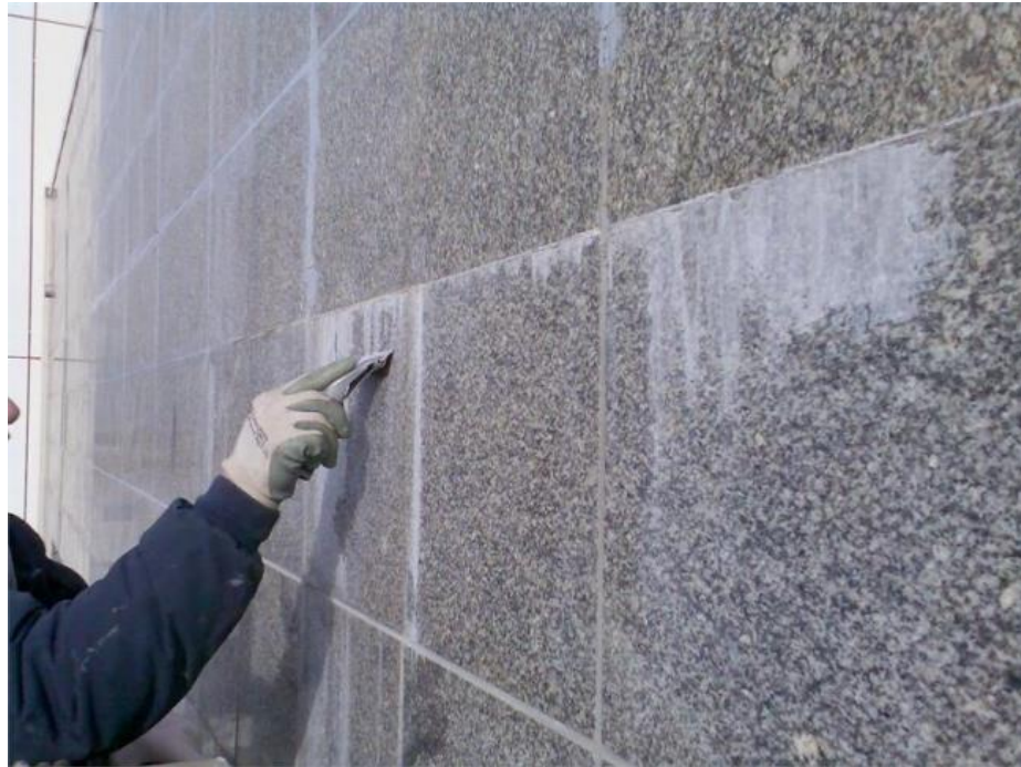
Figura 3 - Eflorescência em revestimento cerâmico
