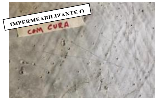
Figura 19 - Riscos realizados no impermeabilizante O com cura.
