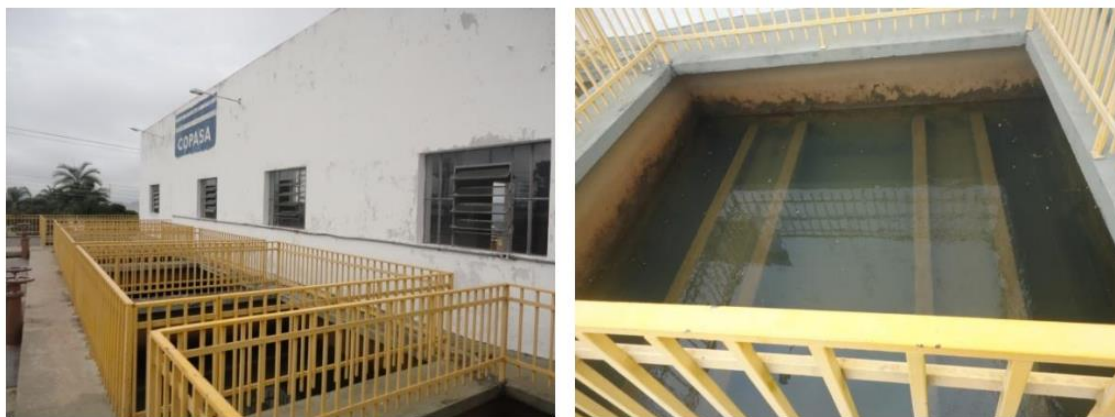
Figura 13- Filtros da ETA de Lavras
