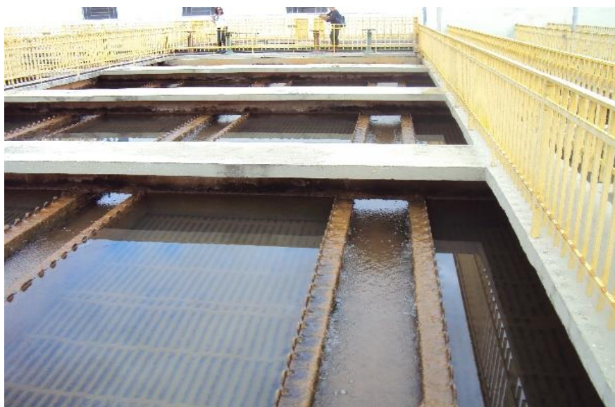
Figura 12- Decantadores da ETA de Lavras.
