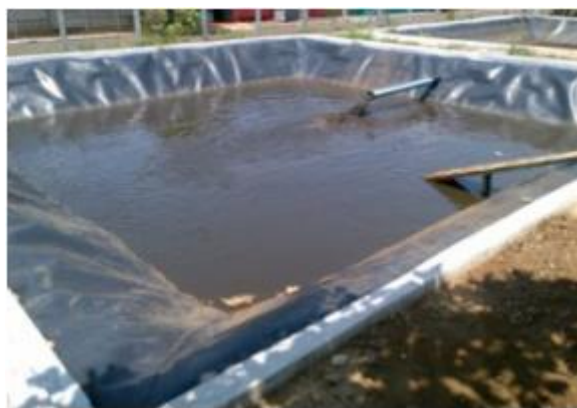
Figura 3- Leito de drenagem.
