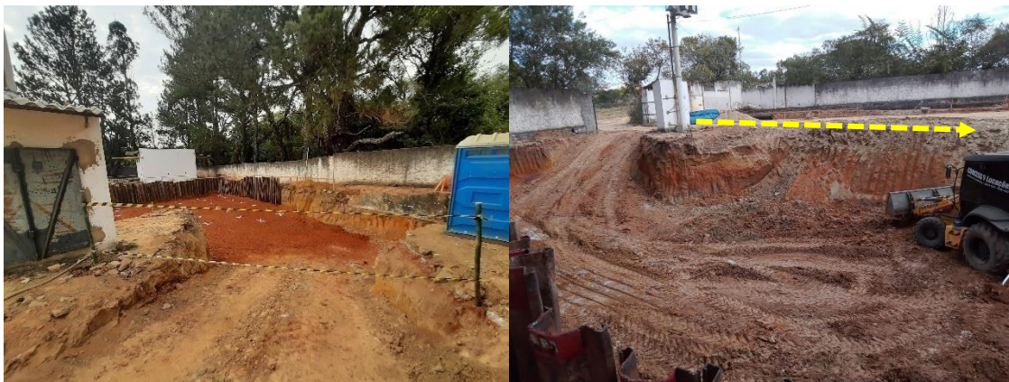
Figura 27- Caminho de entrada de máquinas e sentido da rede de alta tensão.
