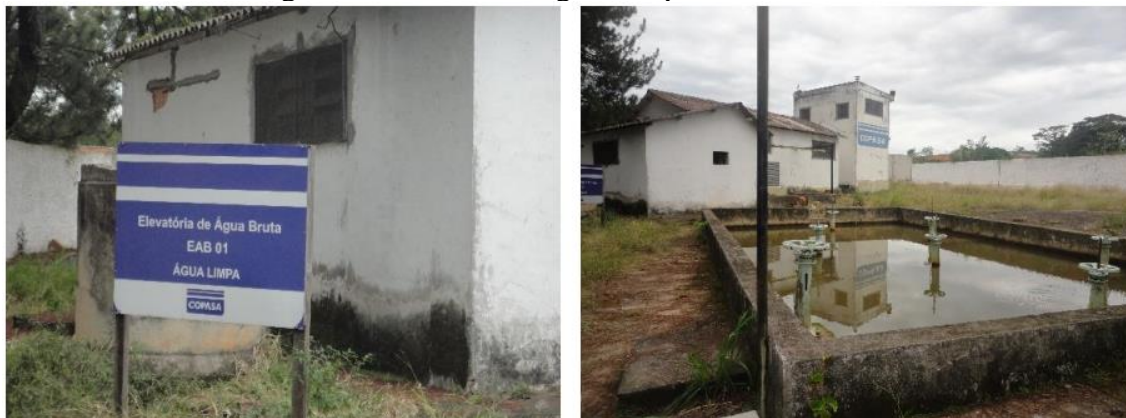
Figura 10- EAB 01 – Água Limpa e reservatório.
