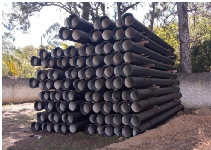
Figura 16- Tubulação de Ferro Fundido DN 300mm.
