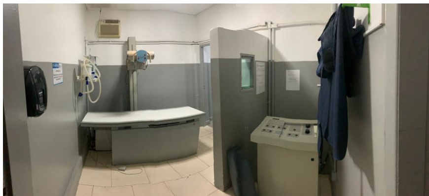
FIGURA 11 – Vista integral da sala de radiologia da Unidade Integrada Veterinária.
