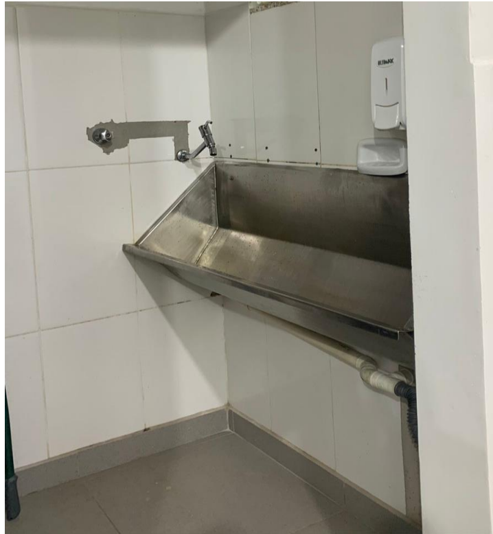
FIGURA 16–Vista parcial da sala de paramentação da Unidade Integrada Veterinária.
