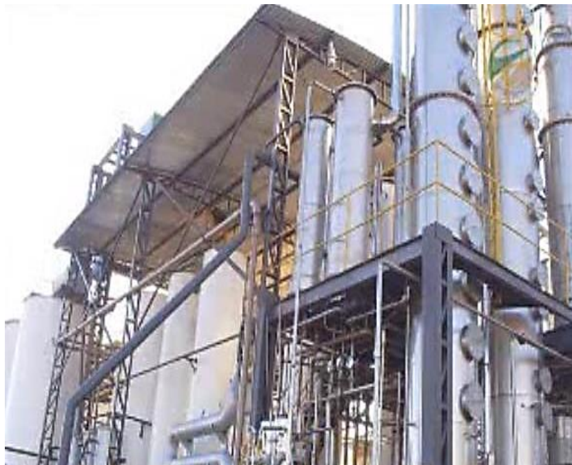
Figura 21 – Tanques de destilação e fermentação.
