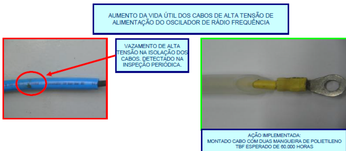
Figura 31 – Kaizen desenvolvido para aumento da vida útil dos cabos de alta tensão.
