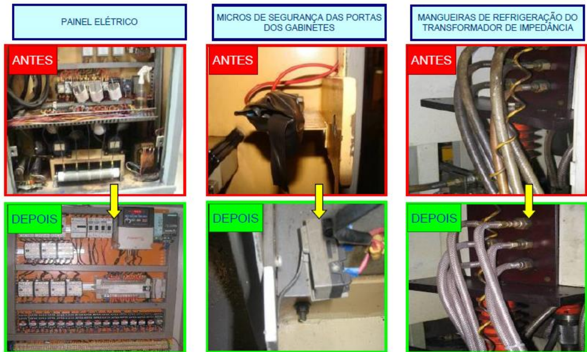
Figura 10: Eliminação da deterioração acelerada nos componentes.
