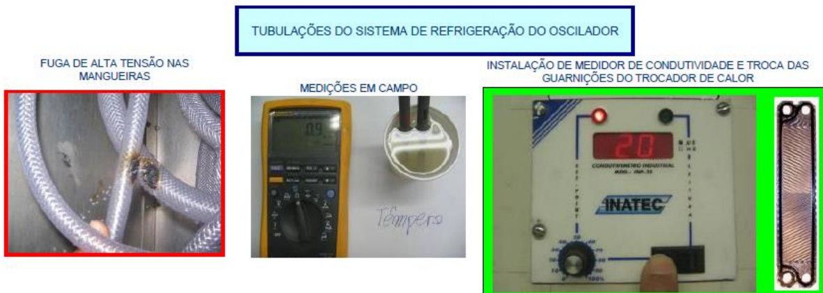
Figura 32 – Kaizen desenvolvido para tubulações do sistema de refrigeração.
