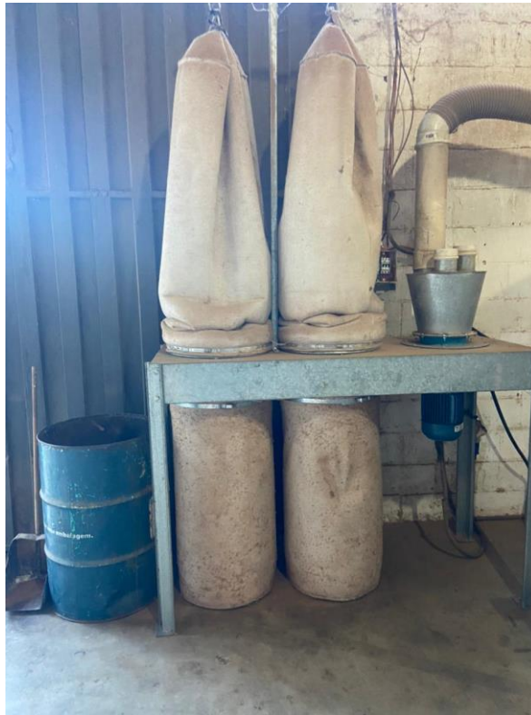
Figura 11- Exaustores responsáveis por deter e armazenar o pó gerado no processo de usinagem.
