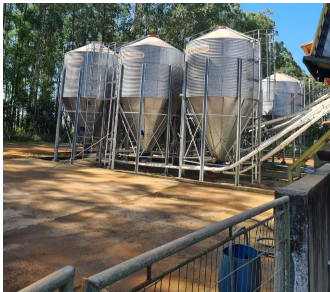
Fig. 8 - Silos de armazenamento de ração do sistema de alimentação experimental
