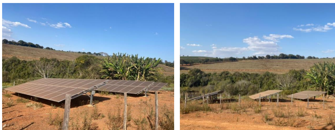
Figura 10 – Usina fotovoltaica em Machado/MG utilizada para a realização do trabalho.
