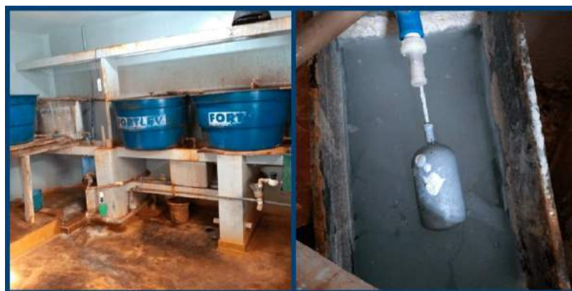
Figura 7 – Sala de preparo dos reagentes. A) Sistema de dosagem. B) Estado dos equipamentos de dosagem.
