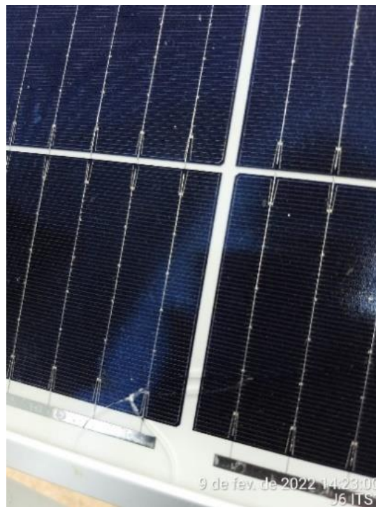
Figura 26 – Módulo trincado sem danos nas células
