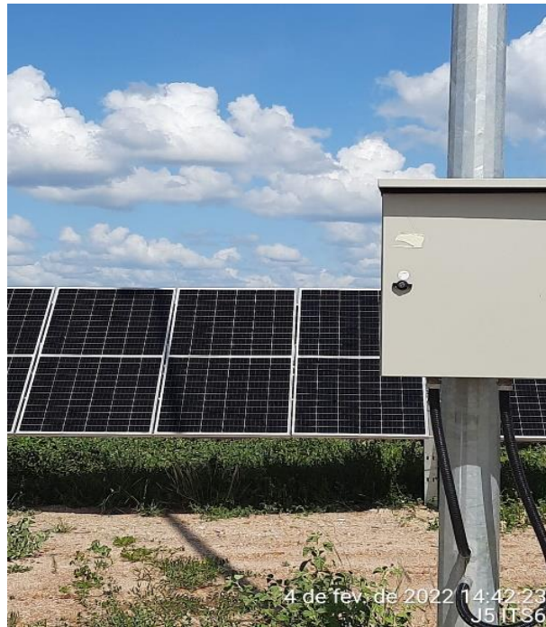
Figura 16 – Sombreamento do poste
