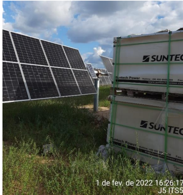
Figura 18 – Sombreamento causado por caixas de módulos
