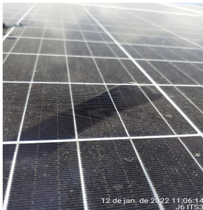
Figura 34 – Acúmulo de poeira nos módulos
