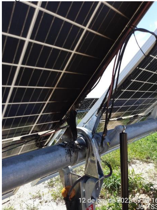
Figura 30 – Falha na conexão
