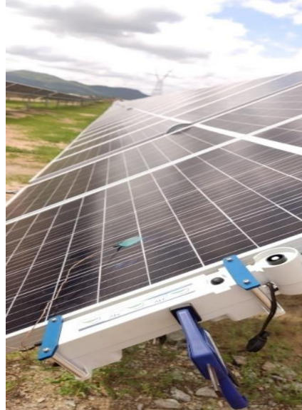
Figura 12 – Fixação do sensor
