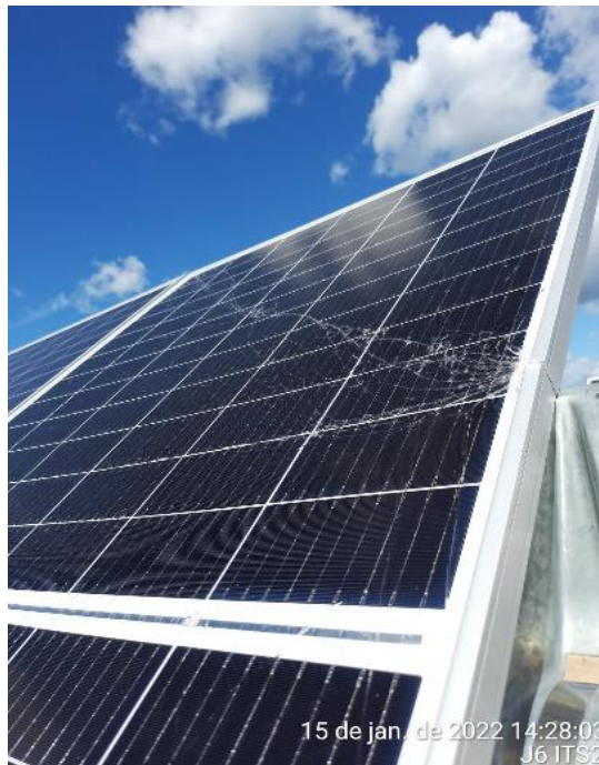
Figura 28 – Módulo trincado com células danificadas
