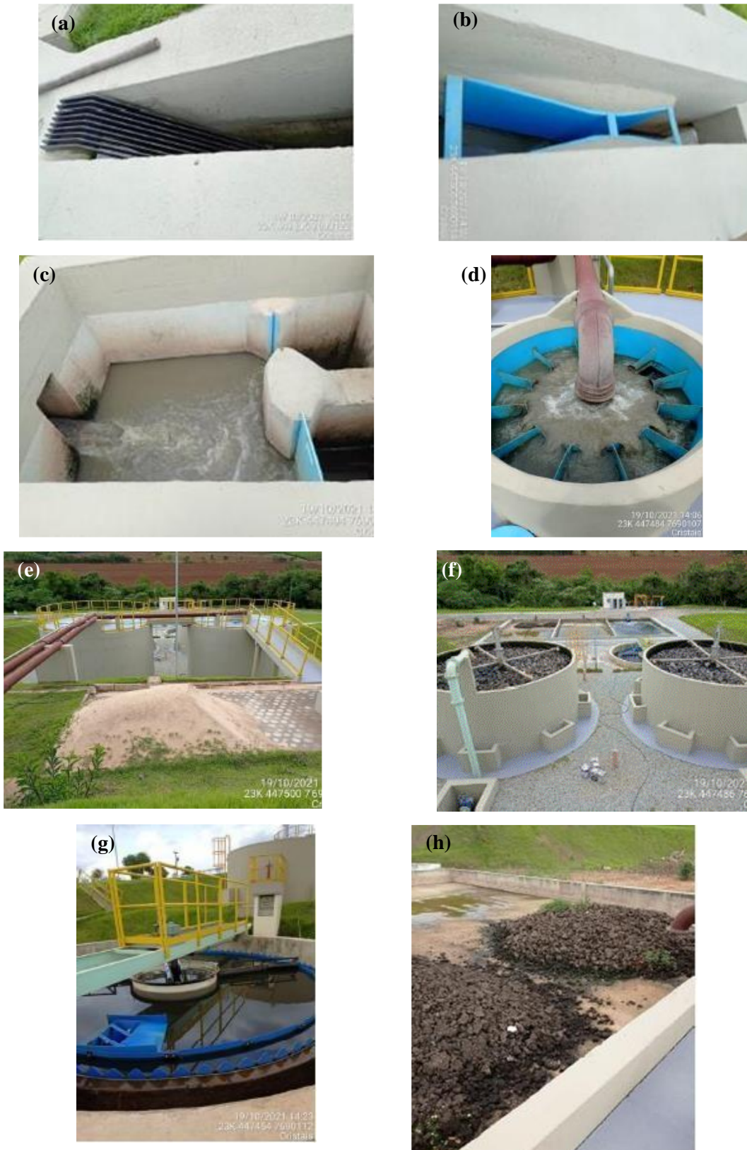
Figura 5. Imagens das principais unidades que compõem a ETE Cristais: (a) gradeamento, (b) medidor de vazão, (c) desarenador, (d) distribuição de esgoto no reator UASB, (e) reatores UASB, (f) filtros biológicos percoladores, (g) decantador secundário, e (h) leito de secagem.
